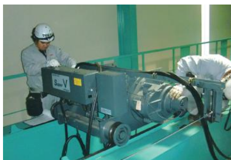
■クレーン法令点検
