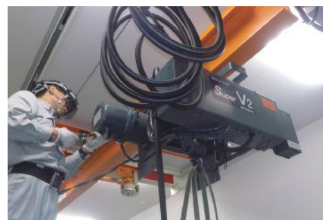
■ホイストクレーン点検・法令点検
