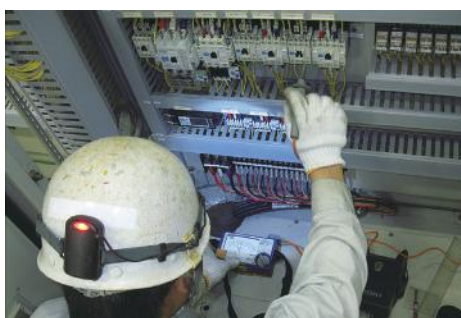
■ホイストクレーン点検・法令点検
