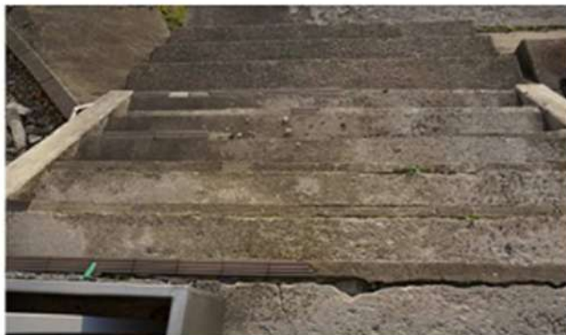
・ 滑り止めのゴムマット設置前
