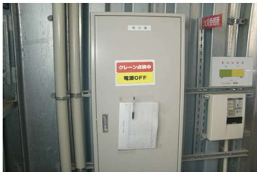
●クレーン点検中／電源OFF(電源盤)
